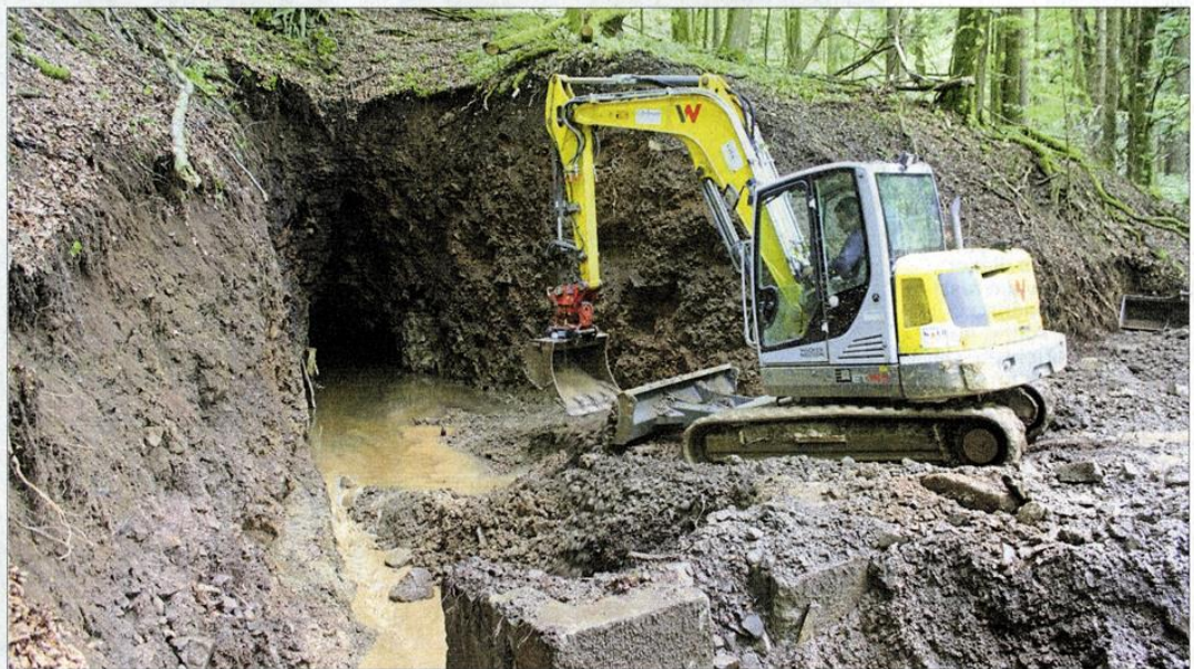
Nur mit schwerem Gerät war es möglich, den Eingang des Stollens zu öffnen.
