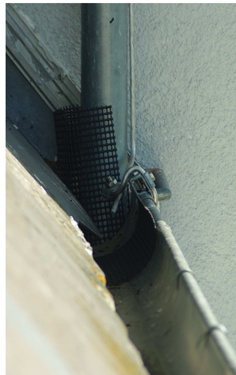
Bild 3: Laubfanggitter als Ausstiegshilfe in der Regenrinne beim Fallrohranschluss
